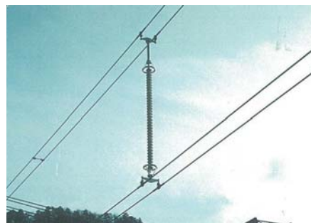
154kV用複導体
