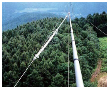
66kV用単導体
